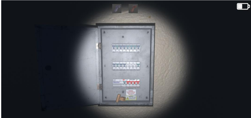
Figura 30. Quadre elèctric sense els fusibles. Font pròpia.
