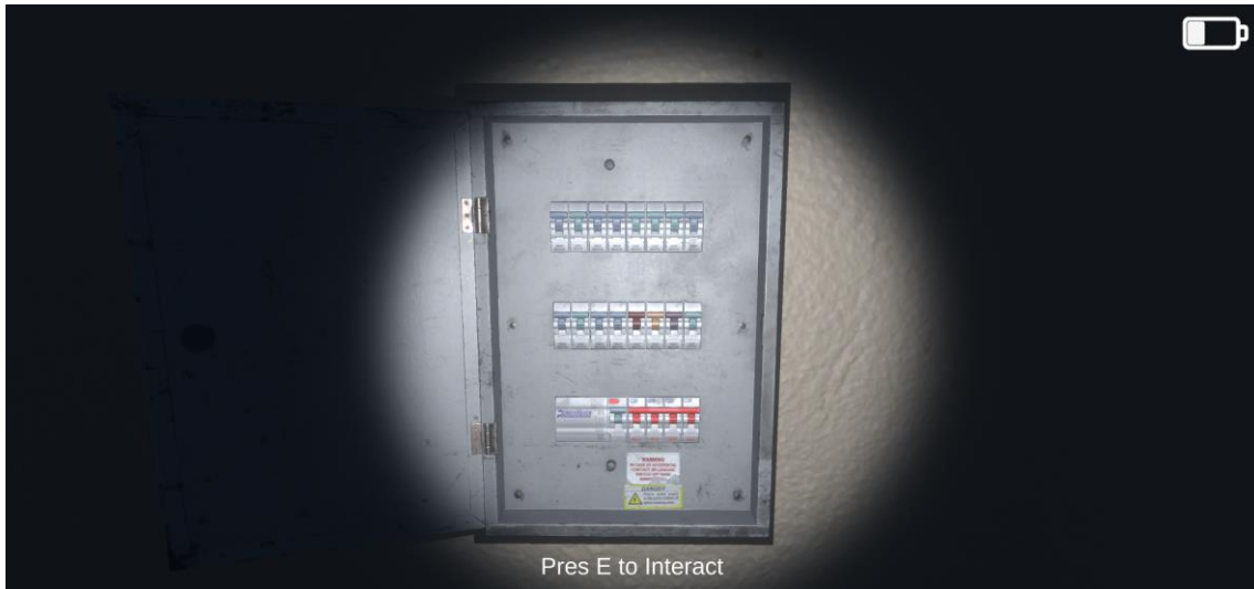
Figura 45. Quadre elèctric obert amb tots els fusibles. Font pròpia.
