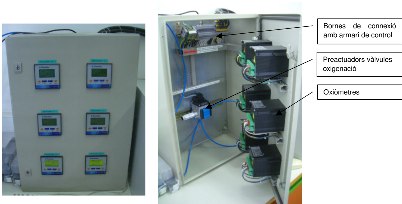
Figura 5.5.- Armari amb els oxiòmetres i els actuadors de les vàlvules
