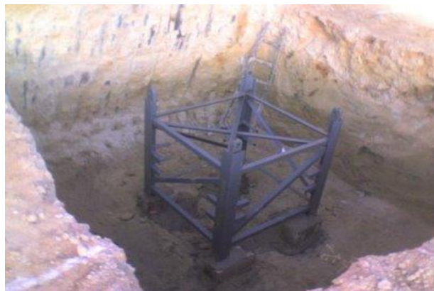
Fig. 3. Ejemplo de una zapata de una torre grúa.
