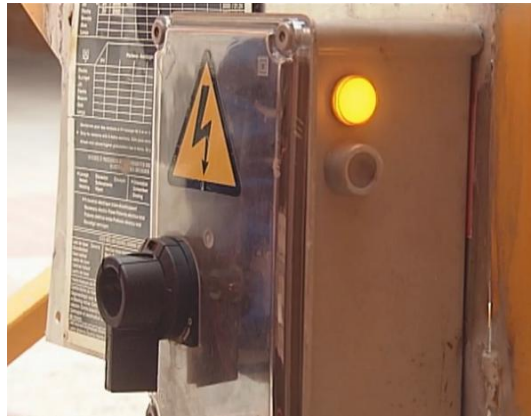
Fig. 9. Interruptor de corte de energía.
