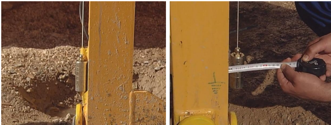
Fig. 3. Aplomado del mástil de una torre grúa.
