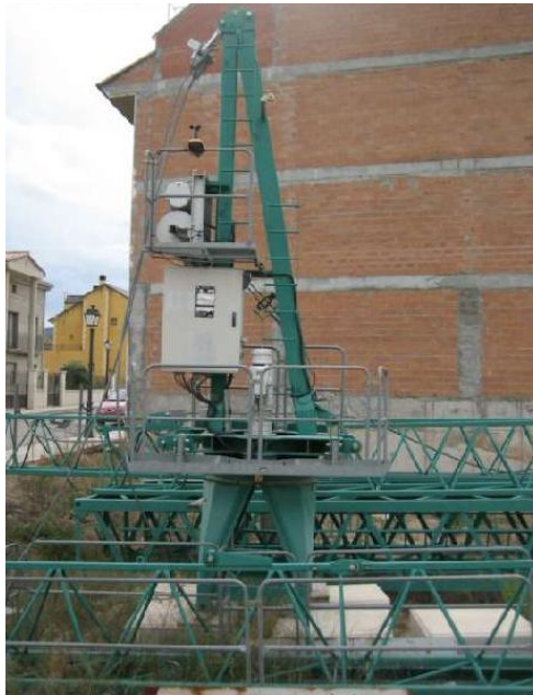
Fig. 6. Armario eléctrico de una torre grúa.
