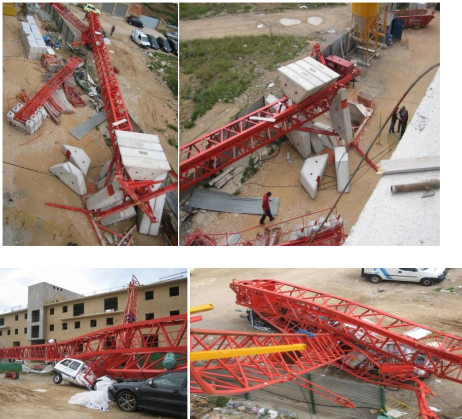
Fig. 22. Accidente de una torre grúa en Tarragona
