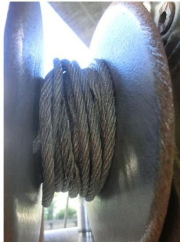
Fig. 7. Cable de una polea de una mezcladora de cemento. Enrollamiento incorrecto.
