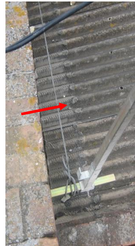
Fig. 10. Ejemplo de un cable galvanizado utilizado en una línea de vida de una cubierta.
