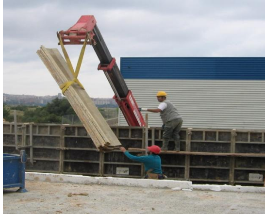
Fig. 32. Incorrecta recepción de una carga por parte de dos trabajadores de la construcción.
