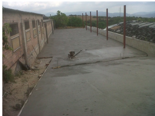
Foto 4: Pavimentació del sòl de la nau. Es deixa zona sense pavimentar que posteriorment ocuparà l'escala-rampa que comunicarà les dues naus.
