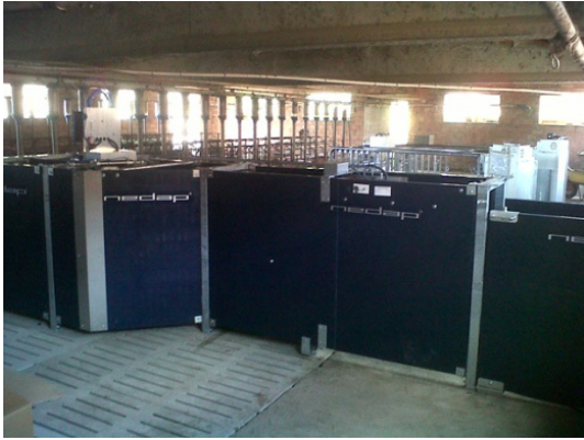
Foto 19: Vista de la unitat separadora des de la zona de separació.
